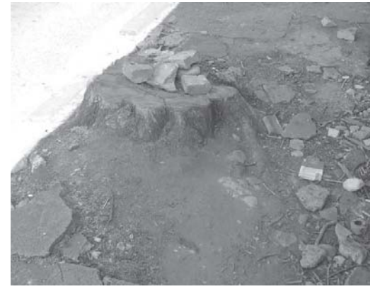
Vejam o tamanho do estrago e de um toco do tronco de uma árvore que impede a passagem de cadeirantes e de carrinhos de bebês na calçada da Av. Dr. Delfim Moreira, no bairro Lagoinha
