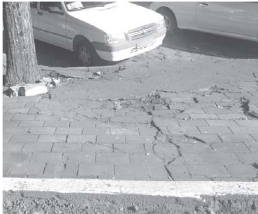
Calçada com vários obstáculos que tem provocado a queda e reclamações de pedestres que passam pela Praça João Pio de F. Westin, ou Praça da Santa Casa, no bairro Mocoquinha
