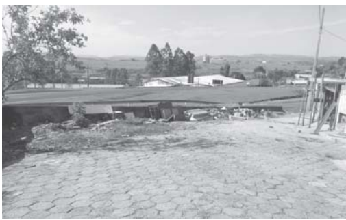
Mureta de concreto repleta de entulhos no entroncamento da Rua Francisco Quintino com a BR 491 na Vila São Pedro, onde acontece frequentemente transtornos com motoristas de carretas
