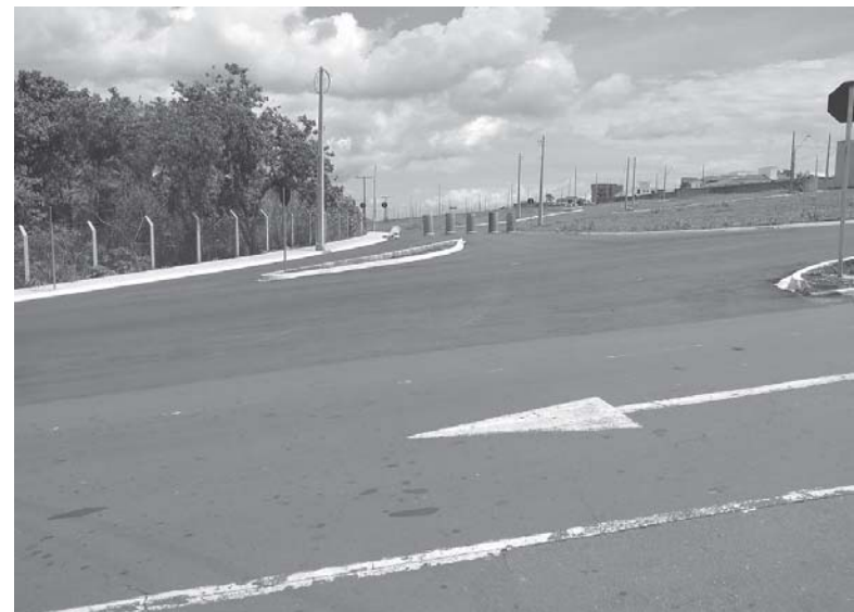
Neste local das ligações das Ruas Ten. José Joaquim e Av. Eclesiastes José da Costa, com a Av. Zezé Amaral, é necessário sinalização de trânsito adequada para evitar acidentes
