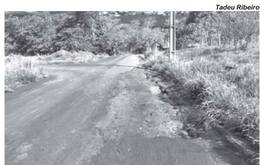
Há meses existe grande erosão na pavimentação asfáltica na rua Francisco de Assis Campos, no Bairro Nascente do Paraíso
