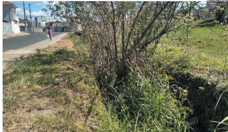
Canalização de gabião no Córrego Coolapa, está repleto de matagal e até árvores, tal fato preocupa moradores das imediações
