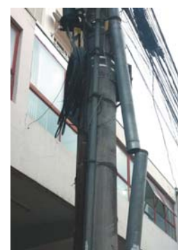
Na Rua Pimenta de Pádua, centro, de frente a loja Zema, tem um poste que oferece riscos a segurança das pessoas que passam ou trabalham nas imediações
