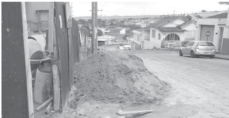
Na Rua Genaro Joele, no Centro de Paraíso, depósito de areia em cima de calçada e leito da rua
