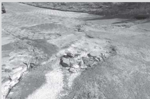
Mais uma vez moradores e condutores de veículos pedem para que a Prefeitura mande consertar buracos na Rua Fausta Soares, no Loteamento Savigni Soares
