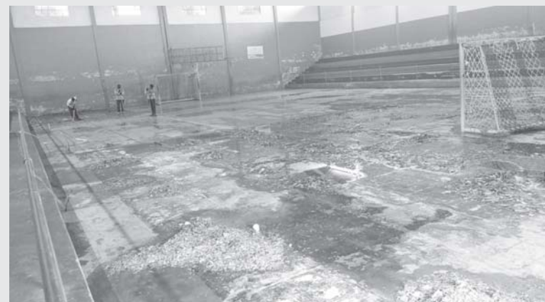
Piso da quadra foi removido nesta semana e receberá nova pintura nos próximos dias
