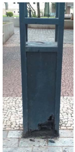
Postes de ferro com luminárias no calçadão da Praça Com. José Honório, centro de Paraíso, estão com as bases corroídas, podendo cair a qualquer momento
