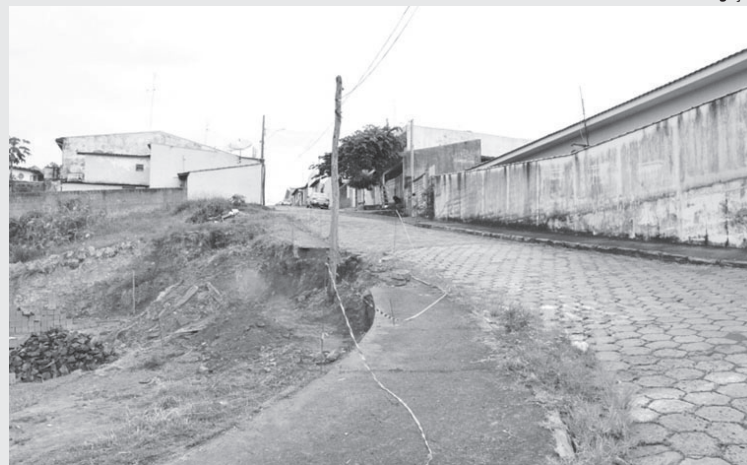
Poste está pendido para dentro do terreno e pode cair com a chuva e vento fortes
