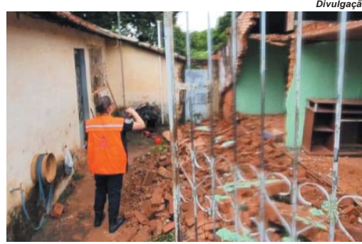
Coordenadora da Defesa Civil, Silvia Duarte disse que faz monitoramento e atenções estão voltadas para áreas de risco no município
