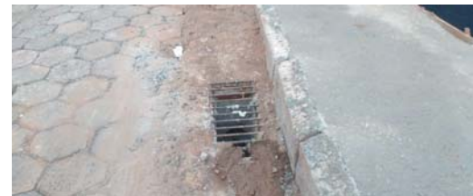
Para acabar com este "valeirão" na rua Alfredo Fidelis Marques, basta colocar bocas de lobo com tamanhos maiores e adequadas para captar águas de chuvas
