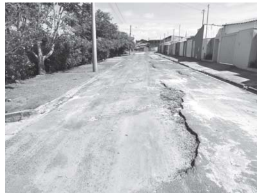
Inacreditável, por volta de uma década os moradores da Rua Dr. Luiz Pimenta Neves, no Jardim Canadá, pedem a Prefeitura para concertar este enorme estrago na Pavimentação asfáltica nesta via pública
