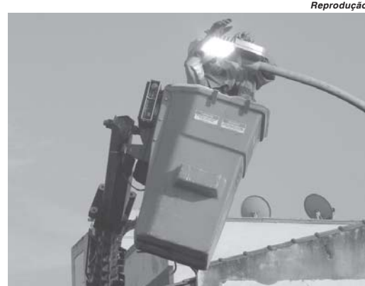
Além da manutenção, iluminação pública da cidade será melhorada com uso de lâmpadas de led
