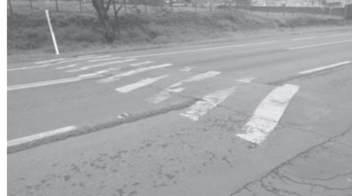
Motoristas transitam em alta velocidade sobre esta lombada devido ela estar nivelada com o piso da pista
