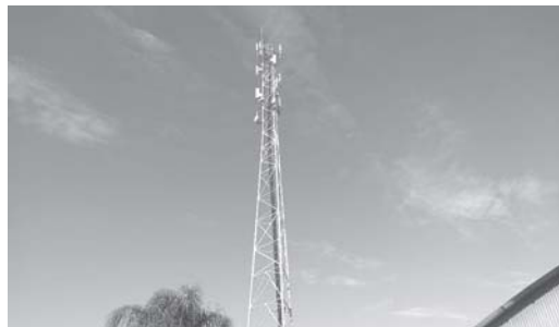
A empresa proprietária da torre de telefonia celular que fica na rua Rita Borges Libório, colocou a luz vermelha de sinalização de alerta
