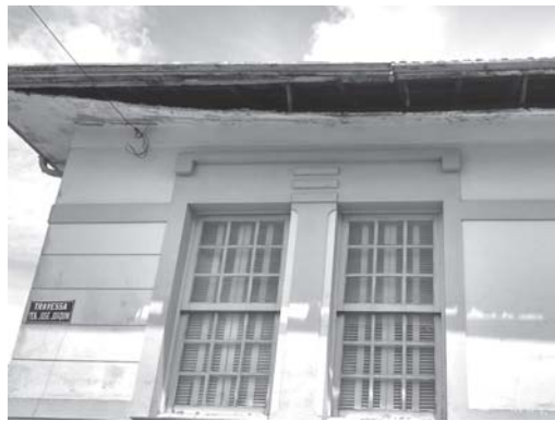
Estuque do beiral de antiga edificação residencial poderá a qualquer momento cair sobre a calçada, com sério risco de atingir pedestres
