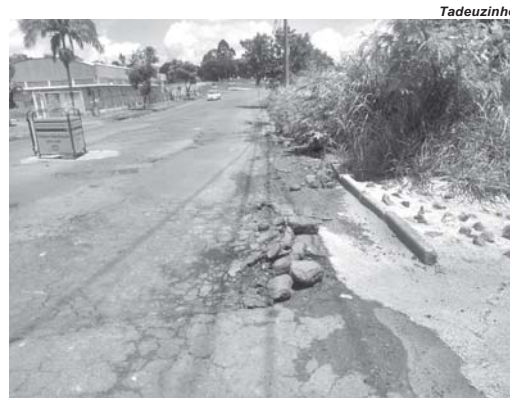
Com o desvio do trânsito de veículos para a Av. Washington Martoni, a pavimentação asfáltica antiga desta via está se estarelando
