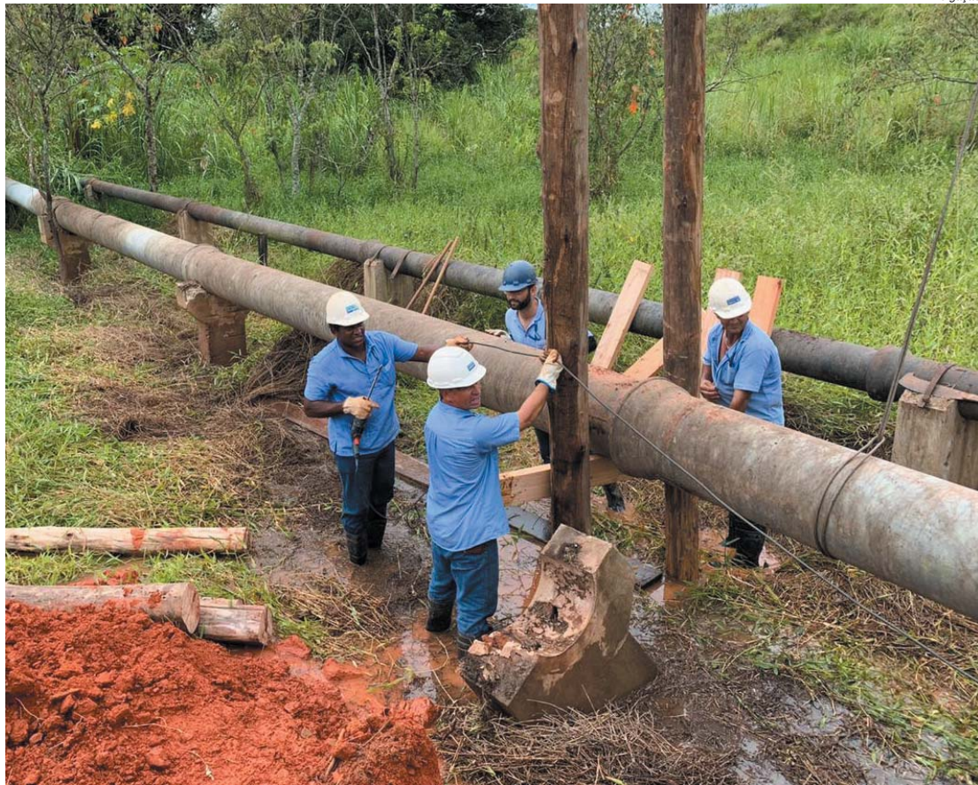
Máquinas e trabalhadores foram utilizados para o restabelecimento do fornecimento de água que foi prejudicado devido ao rompimento de adutoras
