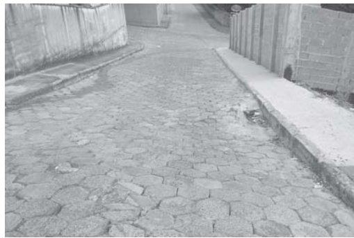
Inconcebível e perigoso Valetão na rua Alfredo Fidelis Marques, continua provocando transtornos
