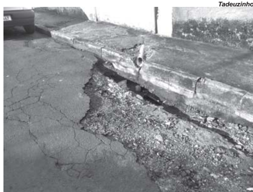
Reclamantes pedem para Prefeitura mandar tampar enorme buraco dentro do leito da Rua Francisco Quintino, na Vila São Pedro
