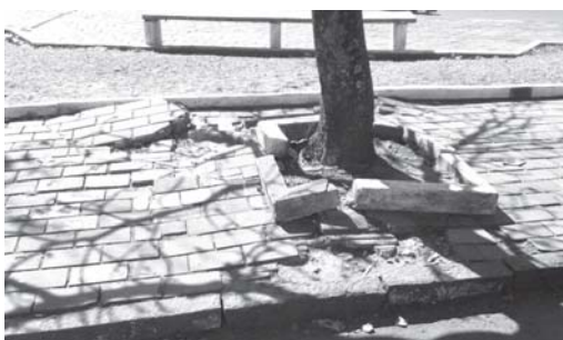
Raízes estão quebrando calçadas e prejudicando acessibilidade de pedestres e cadeirantes a Santa Casa
