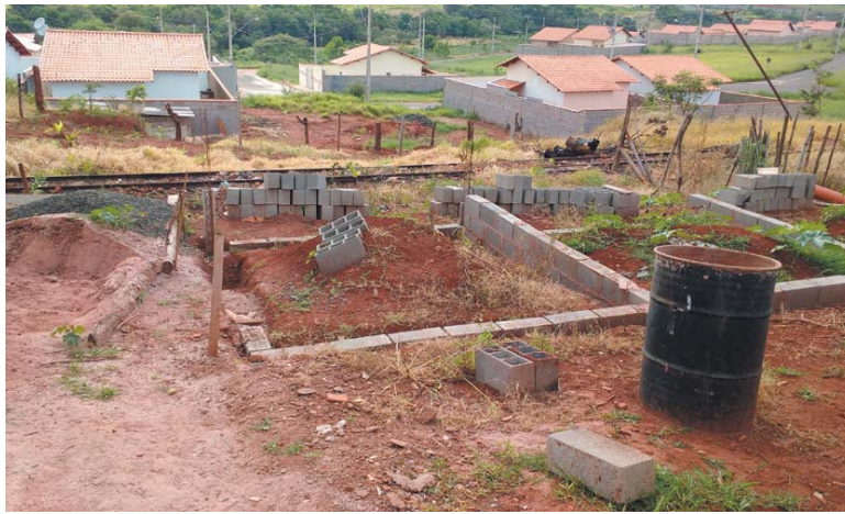
Leito da extinta estrada de ferro, está sendo invadida por construções
