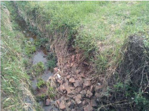
Moradores das imediações, solicitam limpeza de detritos e conter desmoronamento das pedras da parede da canalização do Córrego Coolapa
