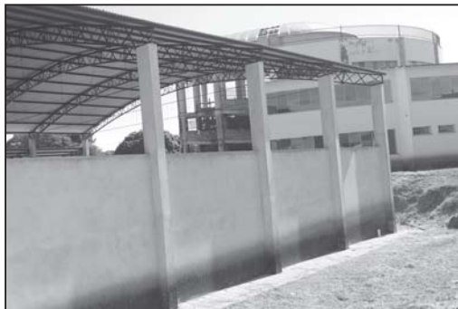
Obra inacabada e paralisada da Escola Professor José Carlos Maldí, no Bela Vista
