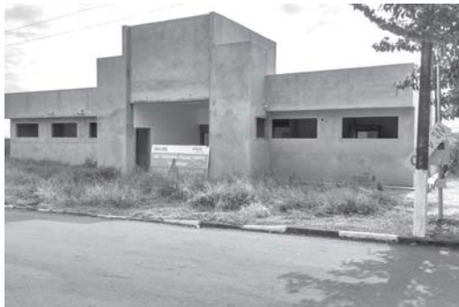
Obra inacabada e paralisada da UBS no bairro Verona
