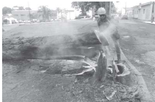
Funcionário da Prefeitura efetuou o corte emergencial da árvore que apresentava risco de queda
