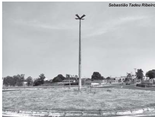
Cortaram o mato ao redor do poste no trevo da MGC 491, mas o principal não fizeram, a troca de lâmpadas queimadas
