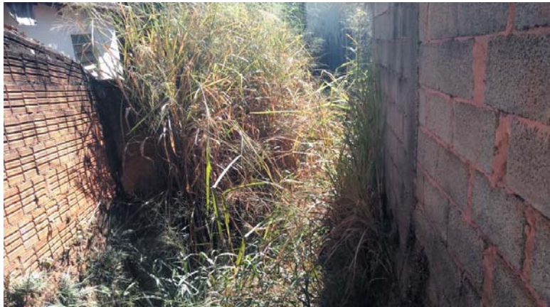
Canalização de água pluvial virou matagal, fato que preocupa moradores das imediações
