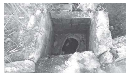
Bocas de lobo sem tampa podem causar acidentes com pedestres, animais e veículos no Parque Industrial I
