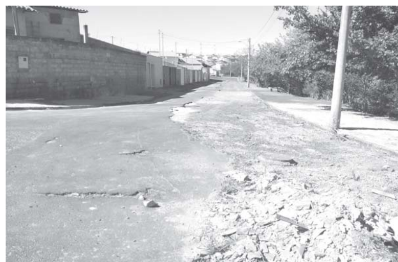
Na Rua Dr. Luiz Pimenta Neves, no Jardim Canadá, está com um de seus quarteirões com a pavimentação danificada e virou ponto de despejo irregular de entulhos, isto há mais de dez anos
