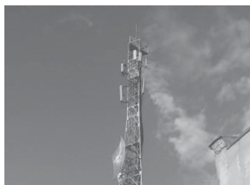
Torre de Telefonia celular que fica ao lado da Praça de Esportes Castelo Branco, a lâmpada de alerta de cor vermelha não acende durante a noite
