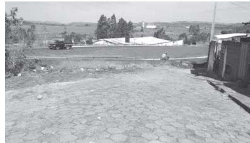
Sinalização inadequada provoca transtornos a Motoristas de Carretas em Rua sem Saída na Vila São Pedro
