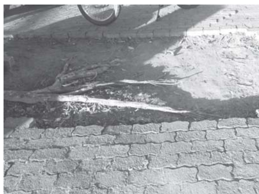
Parque da Lagoinha está necessitando de reparos e reformas Gerais
