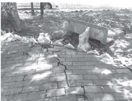
Praça da Bíblia está suja, calçamento danificado e bancos quebrados
