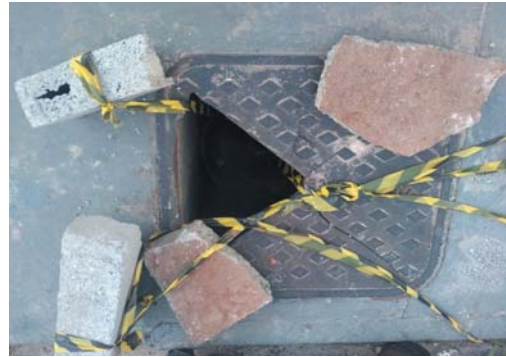
Tampa de caixa de fiação elétrica quebrou e oferece risco de acidentes com Pedestres
