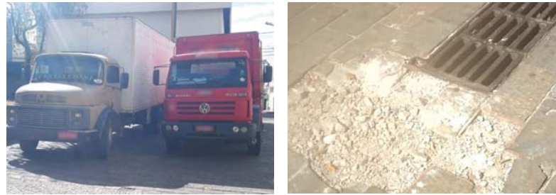
Tráfego de caminhões com carga pesada, estão danificando e esfarelando as pedras do Calçada da Praça Com. José Honório, no Centro de Paraíso
