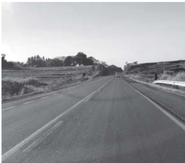
Aterro no km 7,5, próximo ao aeroporto de Paraíso, onde apenas parte do trecho recebeu defensas metálicas, deixando áreas sem proteção
