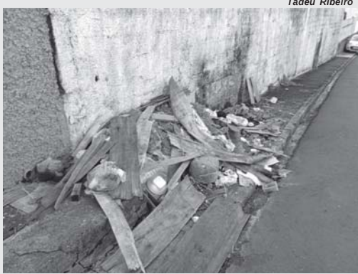
Moradores na Rua Lopes Trovão, já perderam as contas de quanto tempo existe descarte de lixo e entulhos sobre esta calçada
