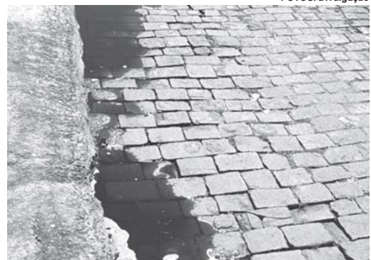
Soda cáustica líquida se espalhou pelo calçamento da via após avaria em galão durante descarga de mercadorias
